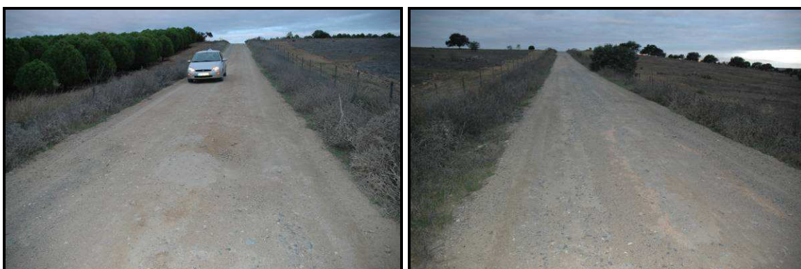
Figura 3.57 e 3.58 – Sensivelmente ao PK 8+450, numa zona baixa da via é perceptível a sua maior degradação (depressões), sendo a zona onde ocorrerá a intersecção com a galeria de interligação entre as futuras barragens da Amendoeira e Magra.
