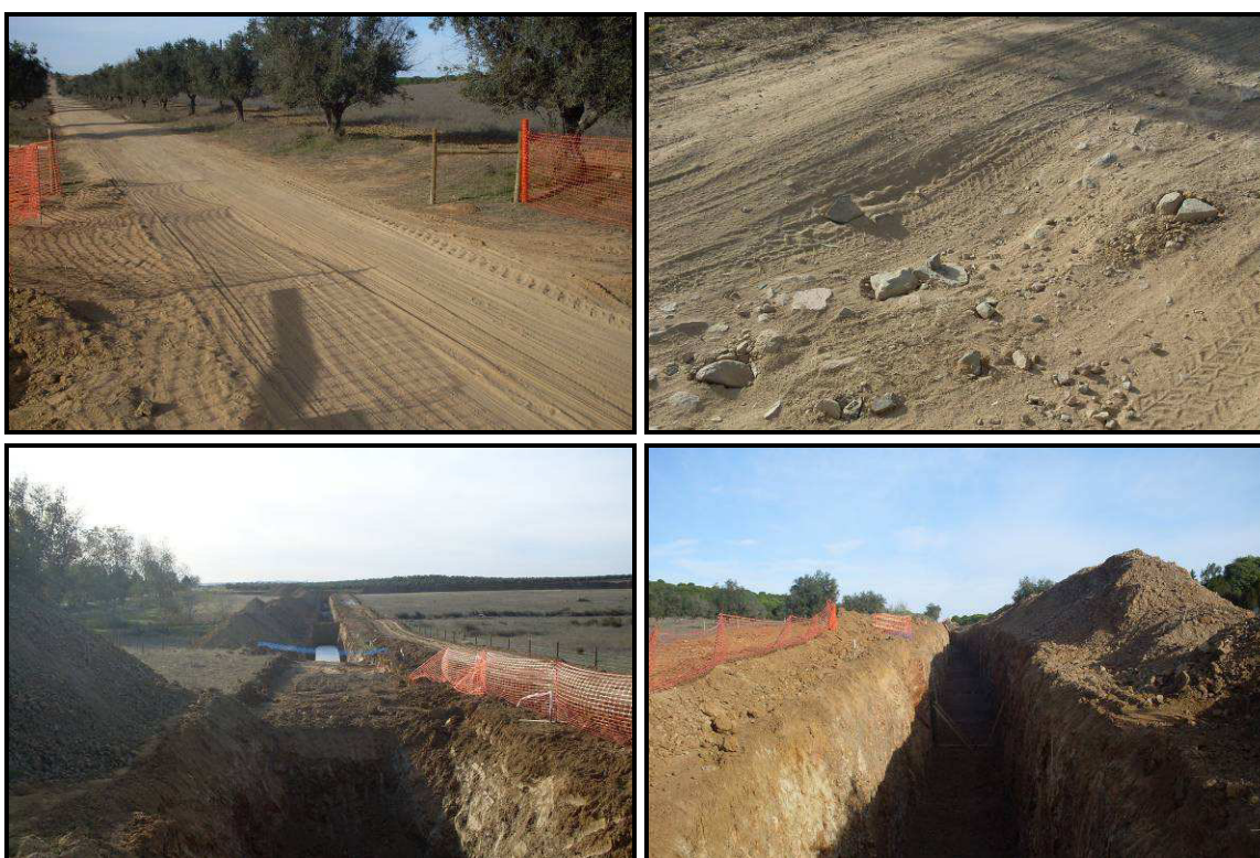
Figura 3.66, 3.67, 3.68 e 3.69 – Registo fotográfico do PK 0+050, onde se verifica a 1.ª interseção da Rede Secundária do CHSPB, sendo perceptível o mau estado de conservação do caminho.
