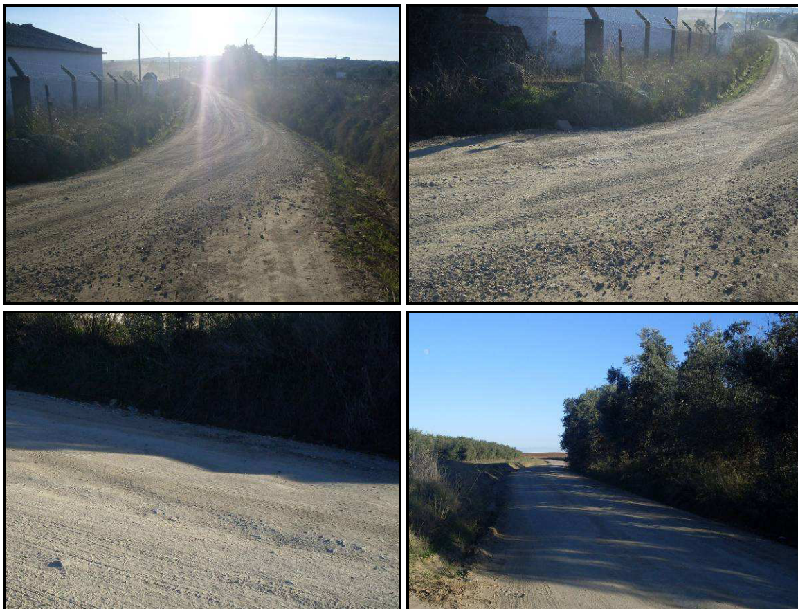
Figura 3.25, 3.26, 3.27 e 3.28 – Sensivelmente ao PK 3+900, numa zona de bifurcação / derivação para um caminho secundário, verificam-se algumas irregularidades no acesso e correspondente degradação.
