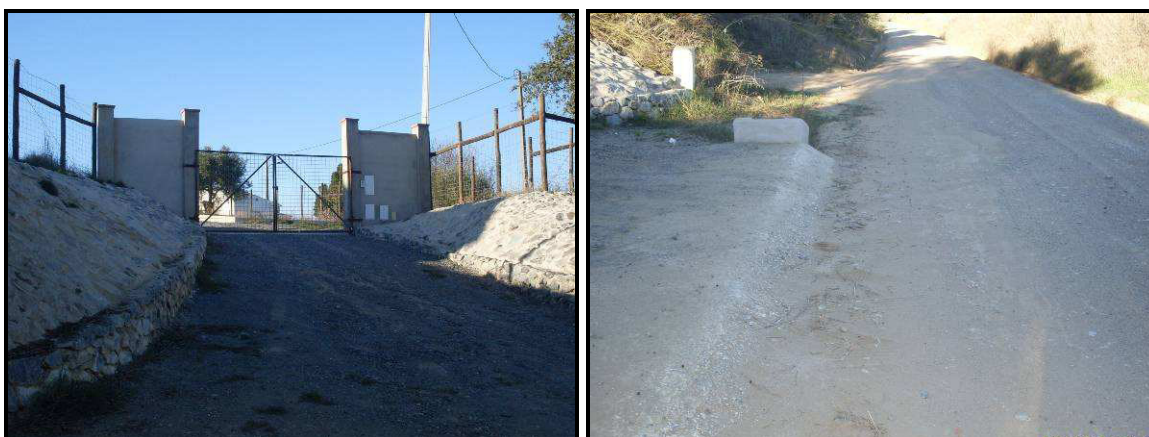
Figura 3.17 e 3.18 – Sensivelmente ao PK 3+100, junto da berma direita (sentido obra – IP8) verifica-se um ligeiro assentamento na ligação à serventia de uma propriedade privada.
